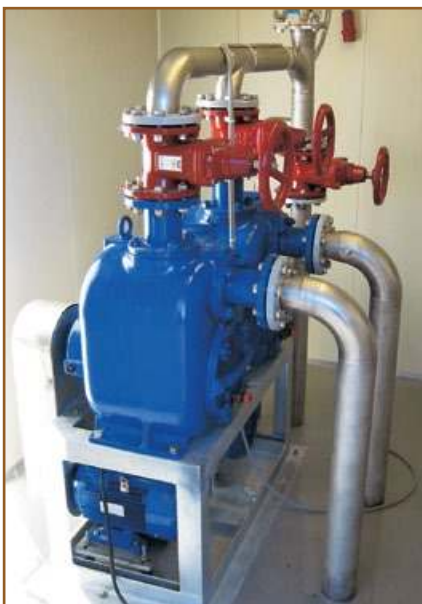
Sewage lift station Abwasser- Hebewerk
